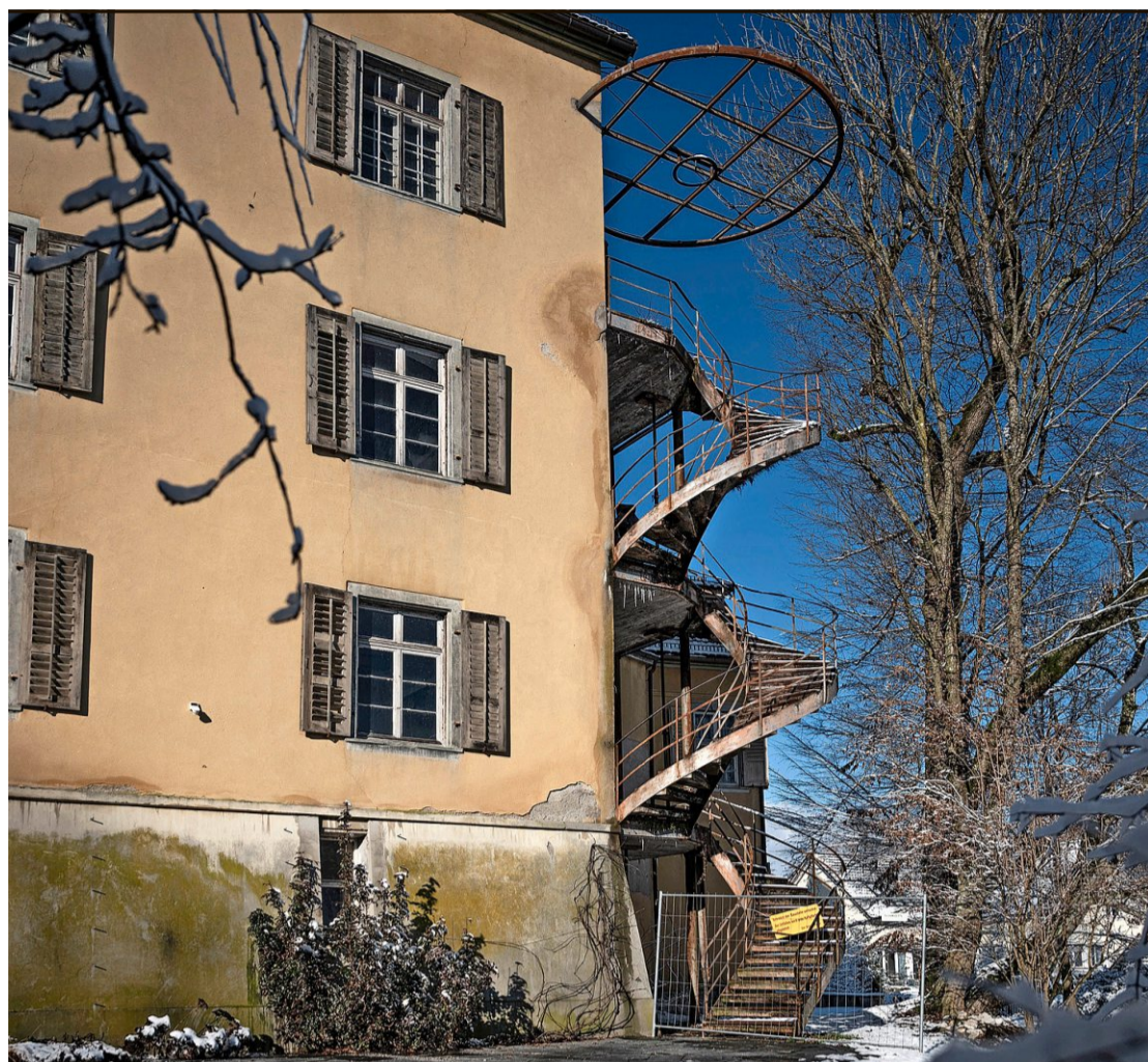
Die rostige Wendeltreppe ist ein Überbleibsel des einstigen Atominstutits im Schloss Luxburg in Egnach TG.
